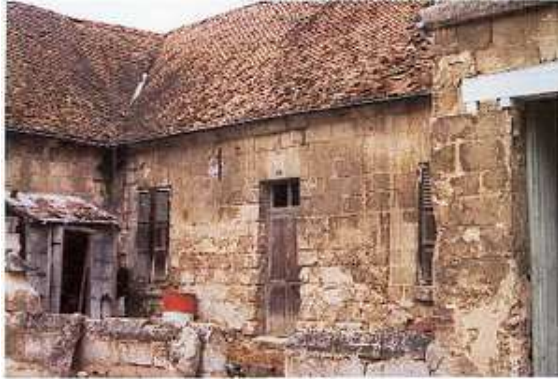
La Maison de Saint-Just en 1989, lors de son achat. Avec sa toiture crevée, son pignon éventré et ses pierres de façade très dégradées, elle menaçait ruine.
